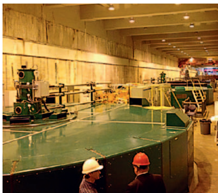
▣ Sala de máquinas
