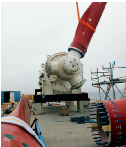
▣ Instalação de HS100 no EMEC, Escócia
