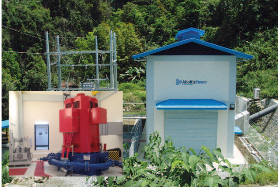
▲ Vista exterior e interior de la CH Irisan 1 isãõ interna e externa de Irisan 1
