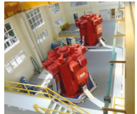
▼ Sala de máquinas de la CH Sabangan
