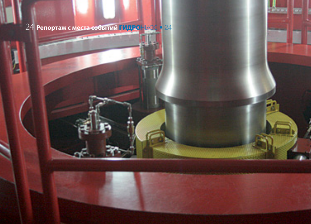
▲ Вид вблизи нового турбоагрегата 3
