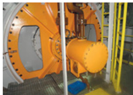
▲ Капсульный гидрогенератор ГЭС «Santo Antonio»
