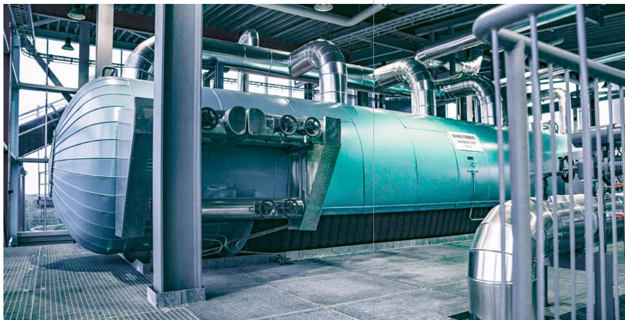
蒸汽温度约为500°C，蒸汽压力为65 bar (a)。
