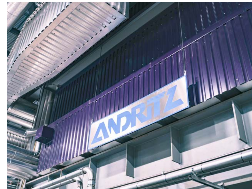
Helsingør Kraftvarmeværk对各种设备指定了颜色用于不同锅炉部件的视觉识别。
